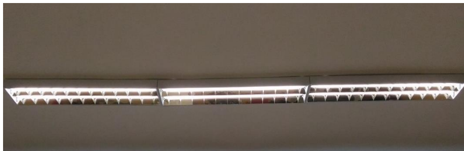
Figura 4.17 - Particolare dei corpi illuminanti ubicati nelle aule
