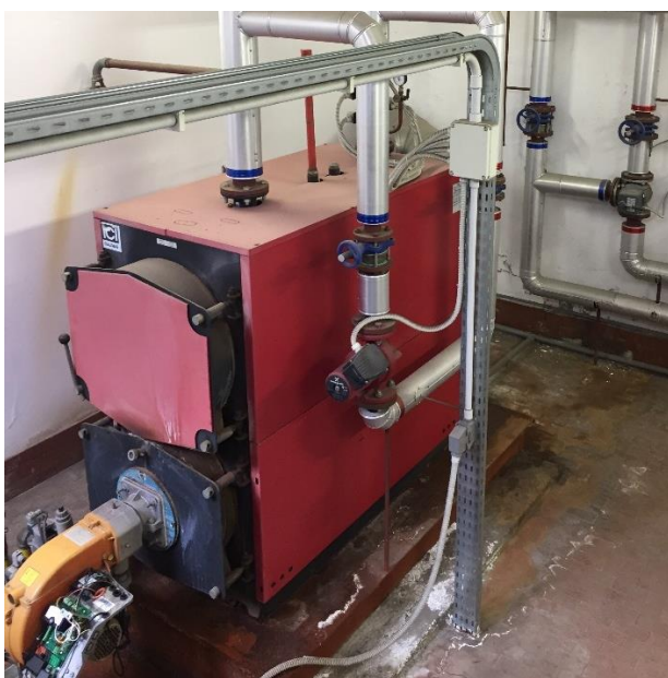
Figura 4.13 - Particolare della caldaia
