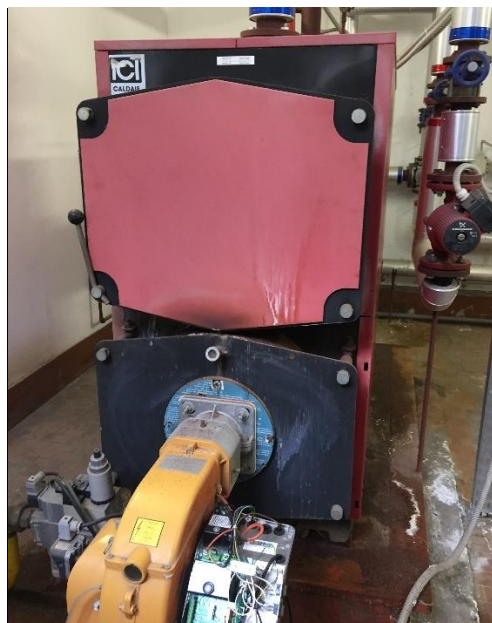
Figura 4.14 - Particolare della caldaia
